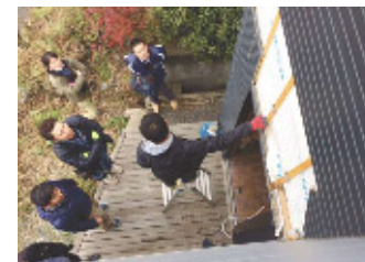
劣化状況を参加者で検証
