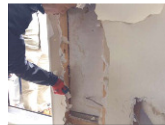
結露は無し。しかしシートに染み有り
